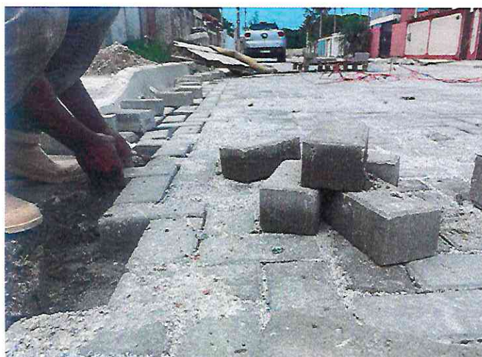
SERVIÇO DE PAVIMENTAÇÃO TAMBÉM É FEITO COM BLOCO INTERTRAVADO DE CONCRETO, QUE AUXILIA NA ABSORÇÃO DAS ÁGUAS PLUVIAIS
