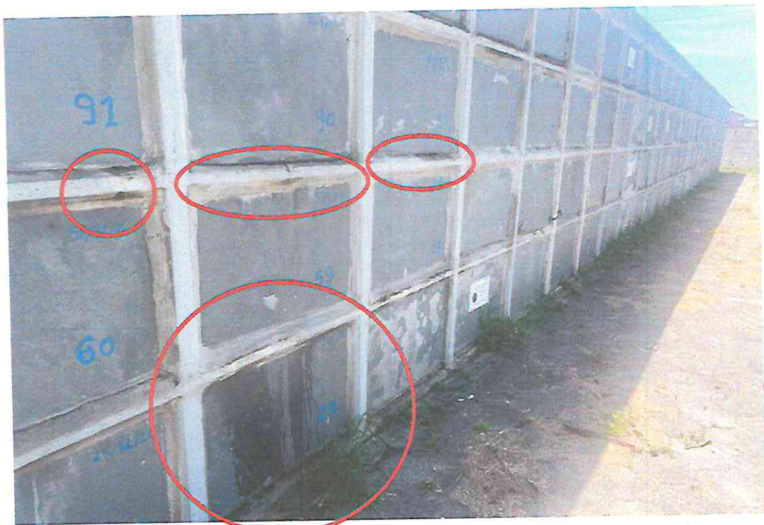
Fotografia de vazamentos interno dos lóculos (destaques nossos)
