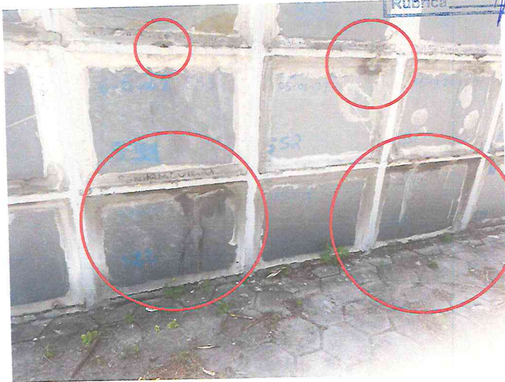
Fotografia de vazamentos interno dos lóculos (destaques nossos)
